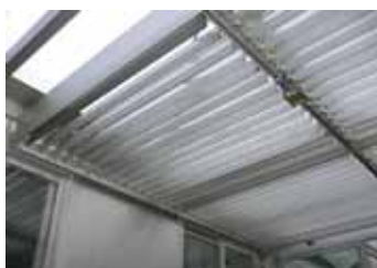
電動ルーバー
